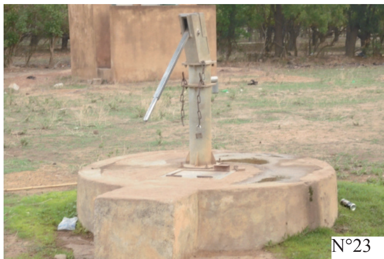
Forage équipé de pompe manuelle (pompe hors service)
