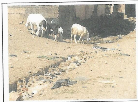
Caniveau obstrué par les déchets solides
