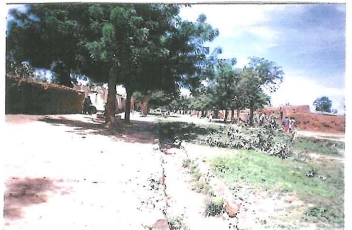
Caniveau maçonné (obstrué)
