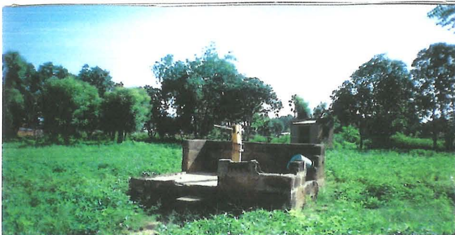
Forage équipé de pompe manuelle
