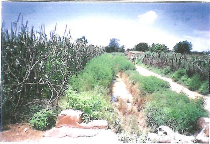
Collecteur maçonné (obstrué)
