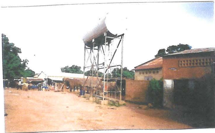
Château d'eau du mini - réseau
