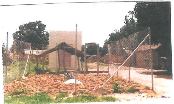
Point de Pompage du réseau principal
