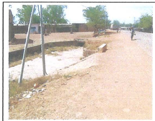
Collecteur artificiel le long de la RN12
