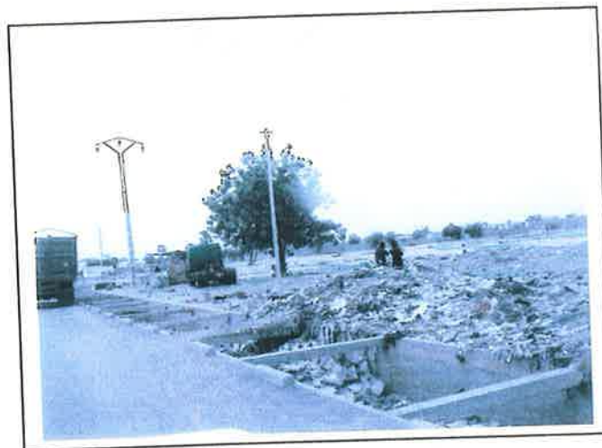
Collecteur obstrué d'ordures
