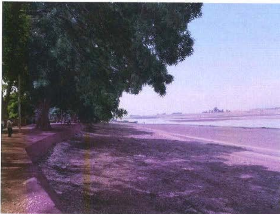
Photo N° 20: Berges du fleuve , aménagées, consolidées dans la zone administrative de Komoguel II.
